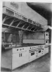
Рис. 1. Общий вид горячего цеха с приточно-вытяжными локализирующими устройствами
